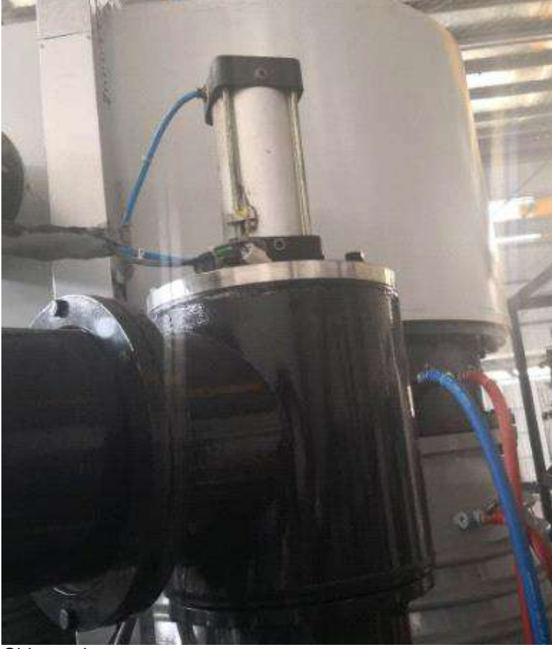
Giriş gaz borusu
